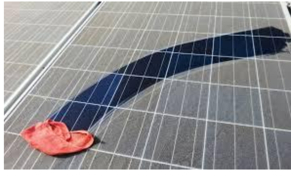
Fig. 1. Panel solar fotovoltaico con suciedad [4].
